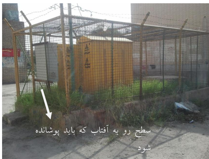
شکل ۴-۱۱: محفظه ترانس حفاظت کاتدیک منطقه کوروش
